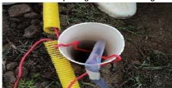
Pressostato ligado a vela acoplado em PVC a 1,40m de profundidade
